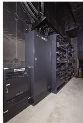
舞台照明デッキネットワークラック・移動形調光器電源盤・移動形調光器接続盤
