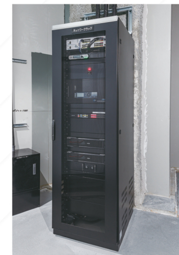
ネットワークラック
