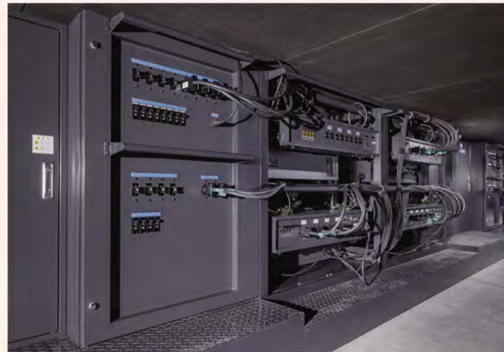
フロア回路用移動形調光器接続盤
