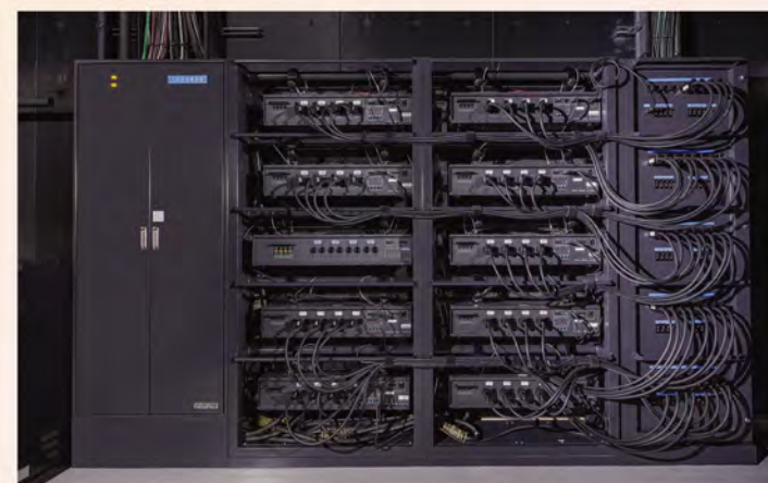
フロア回路用移動形調光器接続盤
